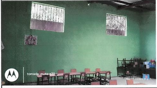
SUSTITUION DE VENTANAS POR VENTANAS PVC
